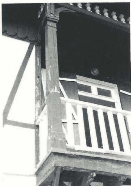
État de délabrement du pignon sud (photo EAN)
